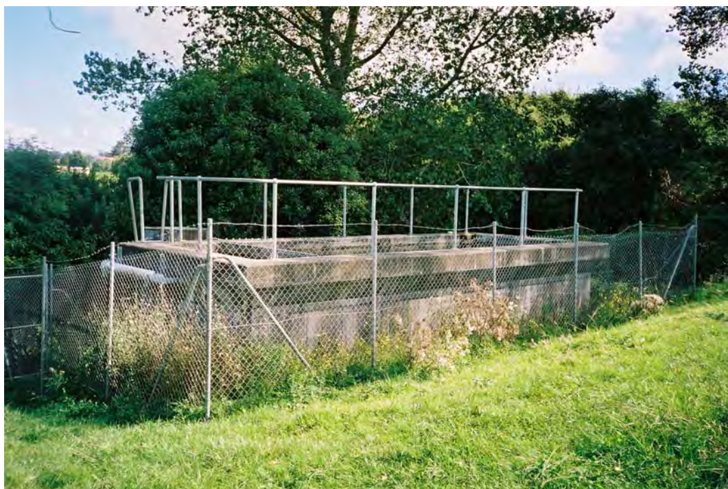
Fig: Piopio WTP clarifier
